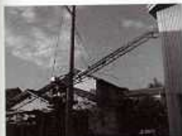
写真1 タワーが折れ曲がり、架線を切って隣家へ接触していた
